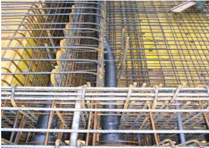
Abb. II.8: S-förmige Querung Spannglied/Bügel in Bewehrungsplan nicht berücksichtigt, keine Schutzschalen gegen Bügel in enger Umlenkung des Spanngliedes.
