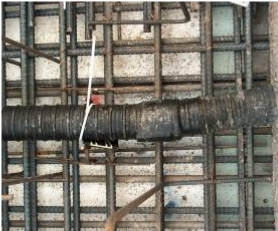
Abb. II.20: Kurze Anschlussstummel der Hüllrohre sind wegen des Risikos der Knickbildung ungünstig.
