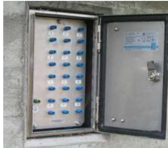
Abb. II.23: Robuster Messkasten aus korrosionsbeständigen Materialien.
